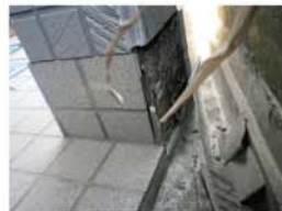
外部の柱にヒビ割れや亀裂などが発生
