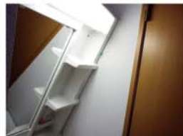
備え付けの洗面台が割れた部屋も
