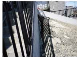
土間コンクリートの下に空洞ができている箇所も
