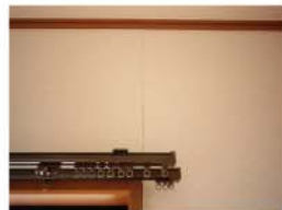
2階には壁クロスに亀裂が入った部屋も
